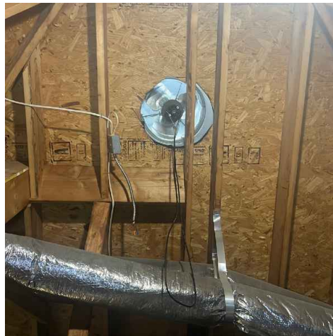
Attic fan Inoperable
