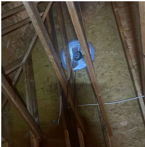
Attic fan Inoperable
