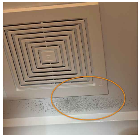
Master toilet exhaust fan
